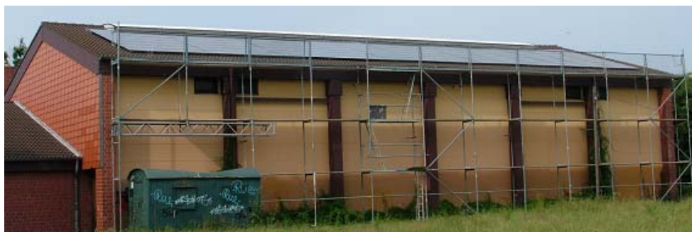
22 kWp-Solaranlage auf der Mehrzweckhalle Velber
